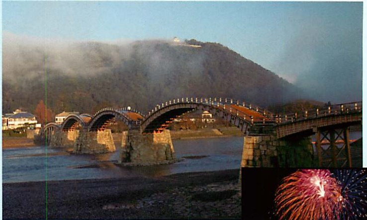
錦帯橋 日本三名橋の筆頭。美しい5連のアーチは当時の技術力ばかりでなく構造の力学的評価も高い。
